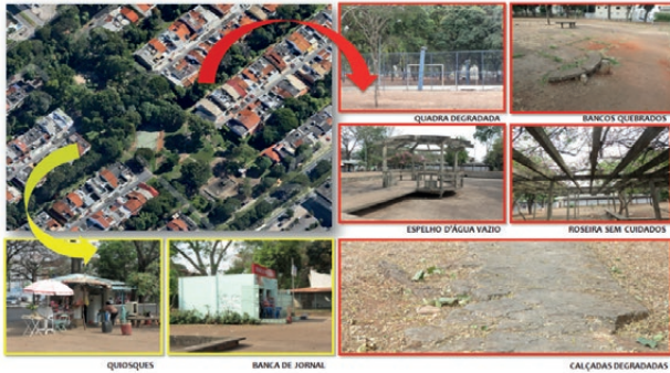
Figura 7 - Estudo das conformidades (em amarelo) e não conformidades (em vermelho), indicando as problemáticas do espaço da praça.
