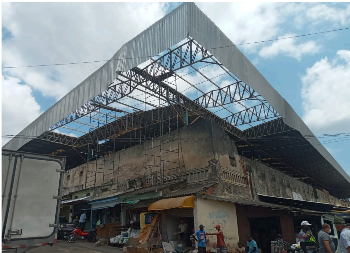
Figura 14: Estado da cobertura do Mercado Central em setembro de 2020. Fonte: Campina TV, postagem no facebook em 11.set.2020
